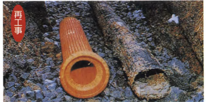
泥土の沈殿で目詰まりをおこした化学製品(3年目)。セラミックストライプ管で再工事中。
